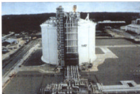
Figura 2. Almacenamiento de GNL
